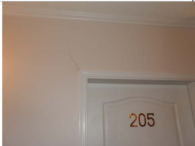
Cracking above unit door
