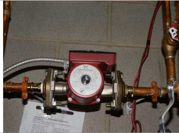
Grundfos recirc pump
