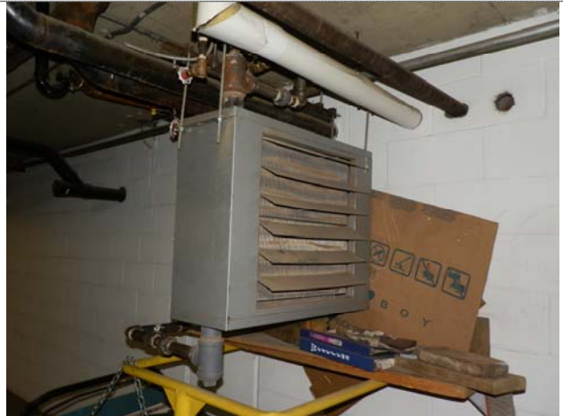
Fan coil heater
